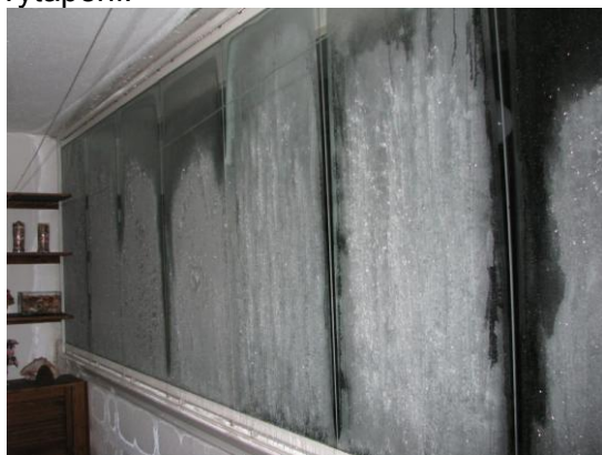
měřené lodžie – ukázka kondenzace par z interiéru
