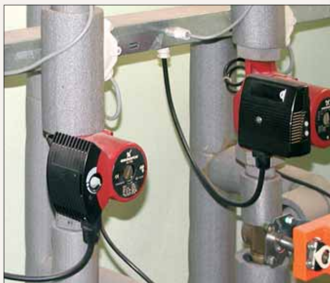
Správně provedená izolace rozvodů teplé vody. (Zdroj: EkoWATT)
