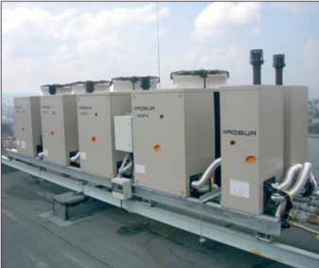
Applikace plynových tepelných čerpadel. (Foto: Robur)
